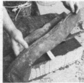
8. Se cubre el molde con sacos húmedos y se deja fraguar el hormigón.
