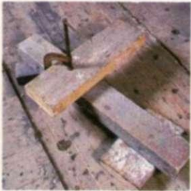
Ensambladura de dos bloques con pernos 1. Se colocan los bloques en la posición adecuada, levantados del suelo y firmemente sujetos unidos con gatos.
