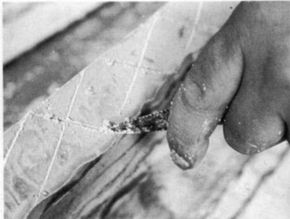
2. En la línea de junta se hace un agarre rayándola en toda su extensión con un cuchillo u otra herramienta metálica.
