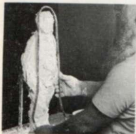
10. Se da forma a unos refuerzos de hierro para que se ajusten a las secciones largas del molde. Deben ser continuos para soportar los puntos más débiles.
