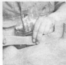
7. La línea de junta se extiende hasta los lados del bebedero y del respiradero, y se construye a lo largo de ella una pared de arcilla de unos 2.5 cm.
